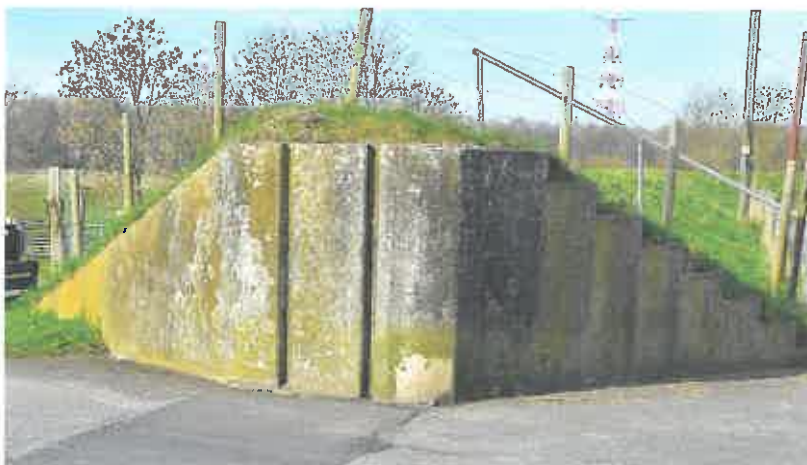
Stöpe Hetlingen Doppelnuten zur Aufnahme der Dammbalken
